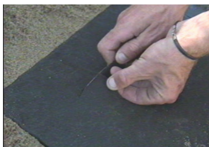
Skär ett X i geotextilen, X:et ska vara något mindre än röret för att sitta åt ordentligt.
